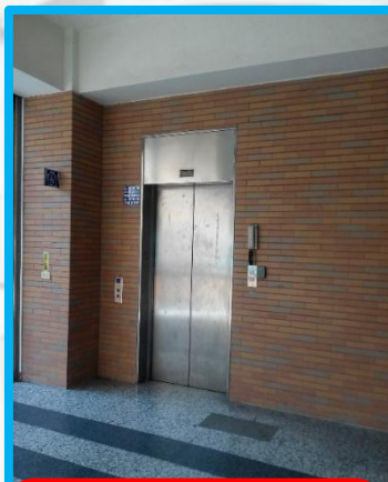
備有電梯方便 搬運重物
