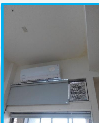
每間寢室皆安裝 冷氣機與排風扇
